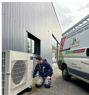
Pompe à chaleur Climatisation
