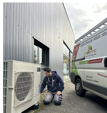
Pompe à chaleur Climatisation
