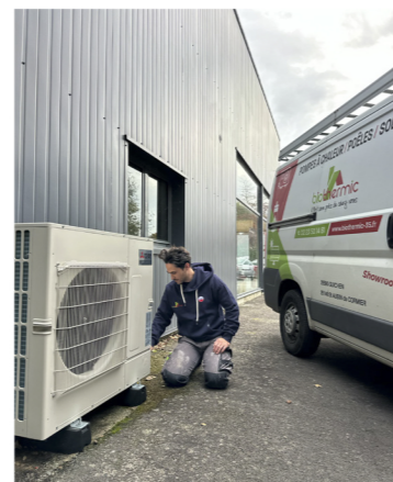
POMPE À CHALEUR CLIMATISATION
