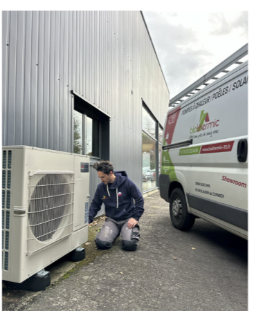
POMPE À CHALEUR CLIMATISATION
