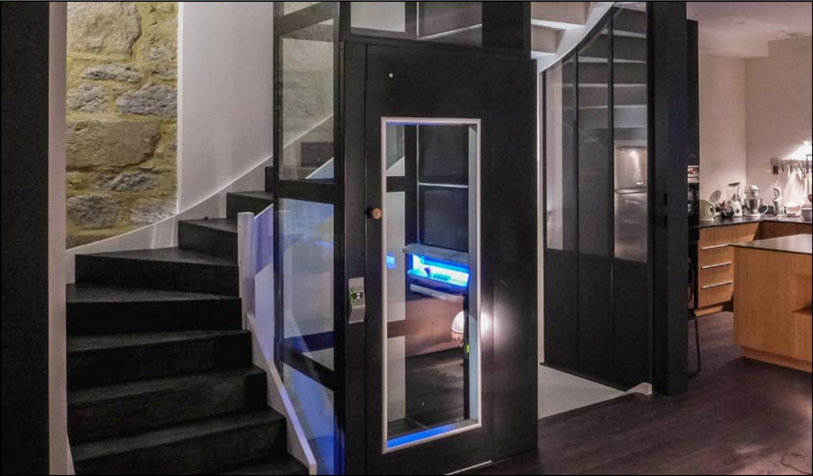
Ascenseur parfaitement intégré !
