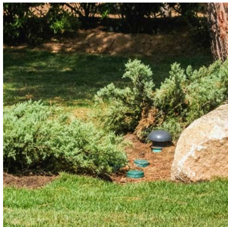
La ventilation s'intègre parfaitement dans le jardin.
