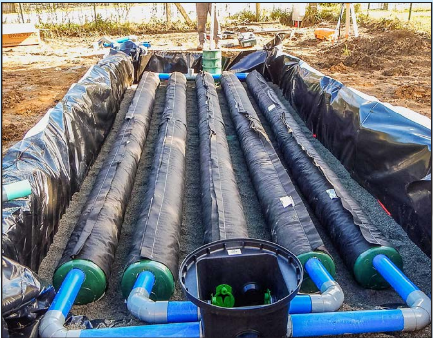
Le système de drainage en place.
