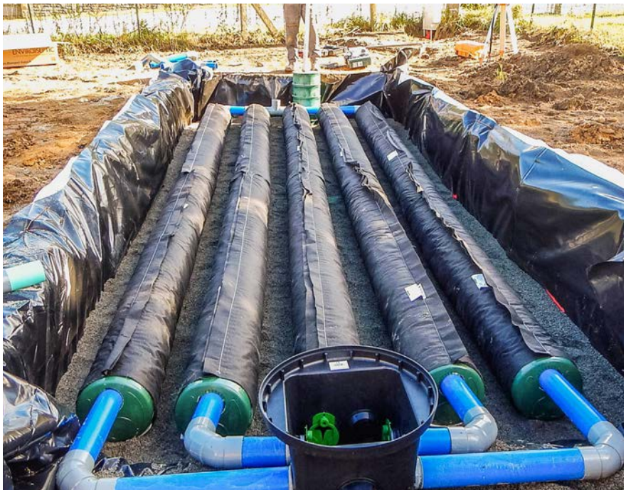
Le système de drainage en place.
