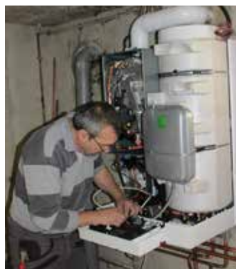
Chaudière à condensation
