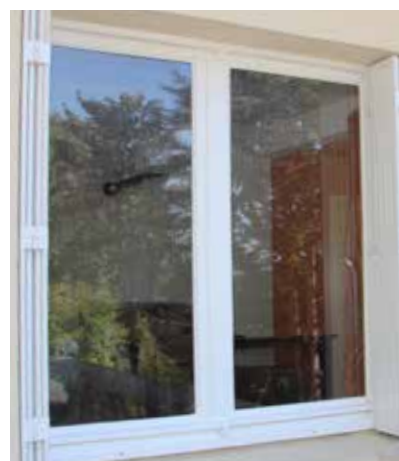
AVANT : Fenêtres et volets bois
